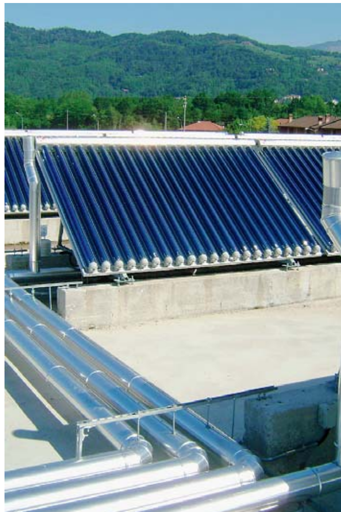
Un particolare del progetto pilota di «solar cooling» a Sotto il Monte
